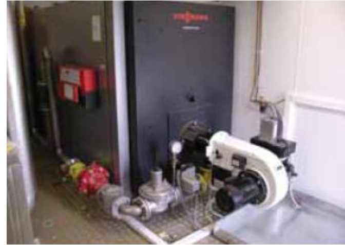
Καυστήρας βιοαερίου για παραγωγή θερμότητας
