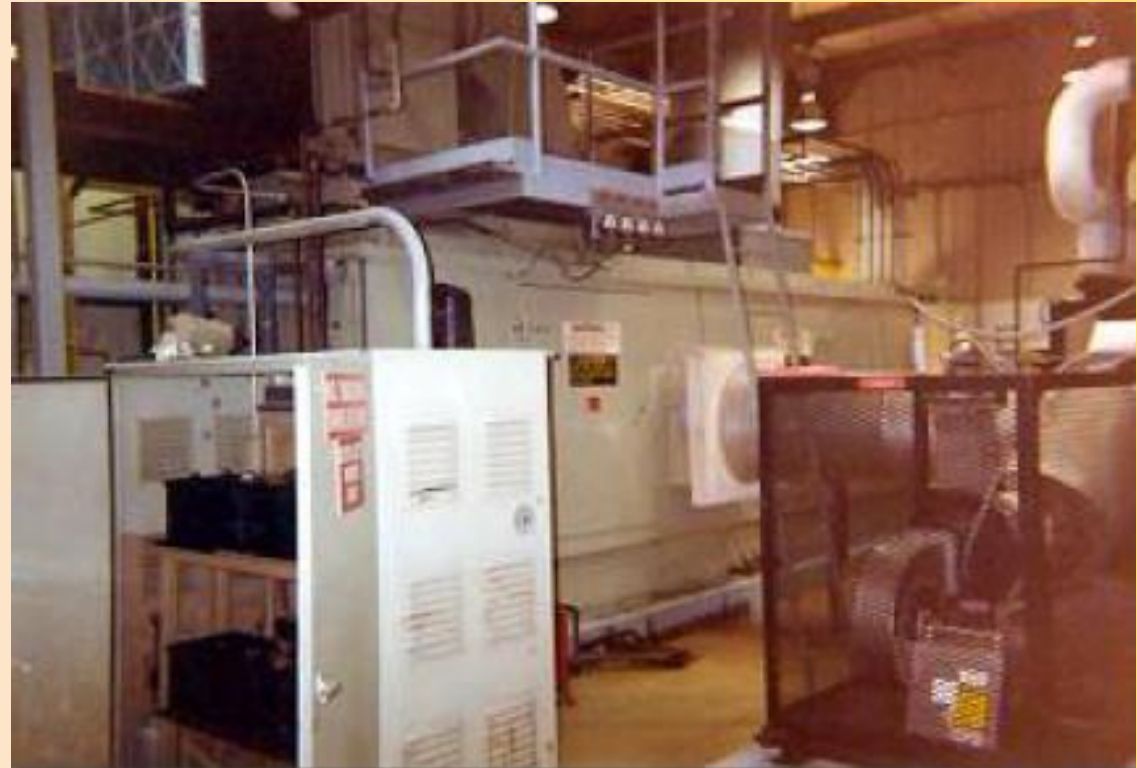
Σύστημα Συμπαγωγής σε Βιομηχανία
