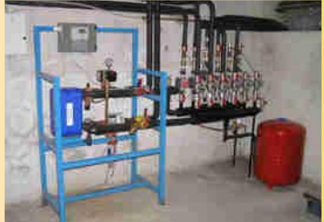
Τυπικές εγκαταστάσεις Θερμικών Υποσταθμών Καταναλωτών δικτύου Τηλεθέρμανσης Αμύνταιου
