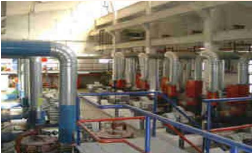
Αντλιοστάσιο Α3 Τηλεθέρμανσης Κοζάνης
