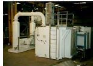
Καταλυτικός μετακαυστήρας VOC.
