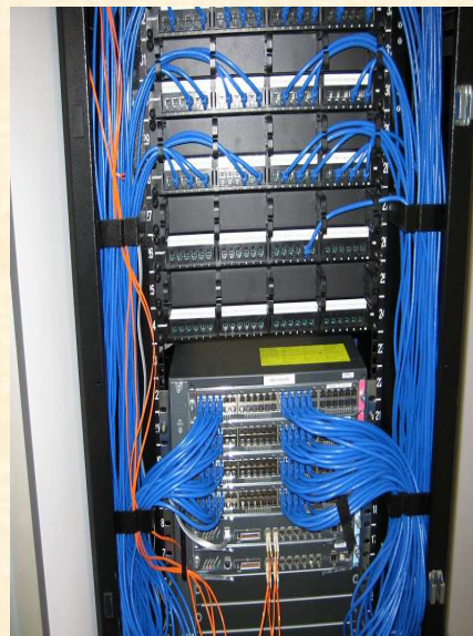
Εγκατεστημένα switches με καλωδιώσεις
