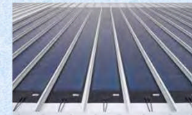
Εφαρμογή εύκαμπτων φωτοβολταϊκών άμορφου πυριτίου σε βιομηχανική στέγη
