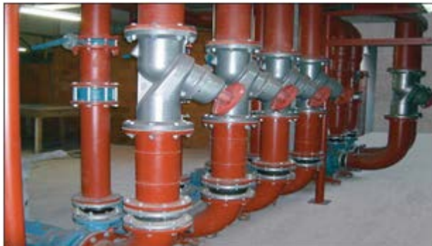
Εικόνα 3.2.7. Βαλβίδες υδραυλικής εξισορρόπησης δικτύων θέρμανσης – κλιματισμού.
