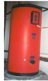
Κεντρικό μπόιλερ ζεστού νερού με θερμομονωτικό μανδύα.
