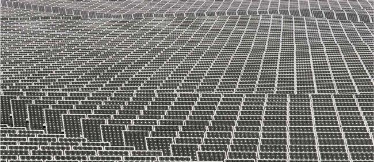
Εικόνα 6.11: Ολική οπτική αλλοίωση έκτασης λόγω εγκατάστασης μεγάλου φωτοβολταϊκού σταθμού.
