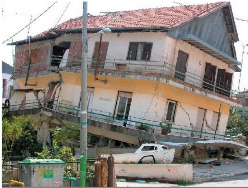
Σχήμα 4: Το κτίριο (τριώροφο+σοφίτα) της οδού Ζαμπέλη που κατέρρευσε
