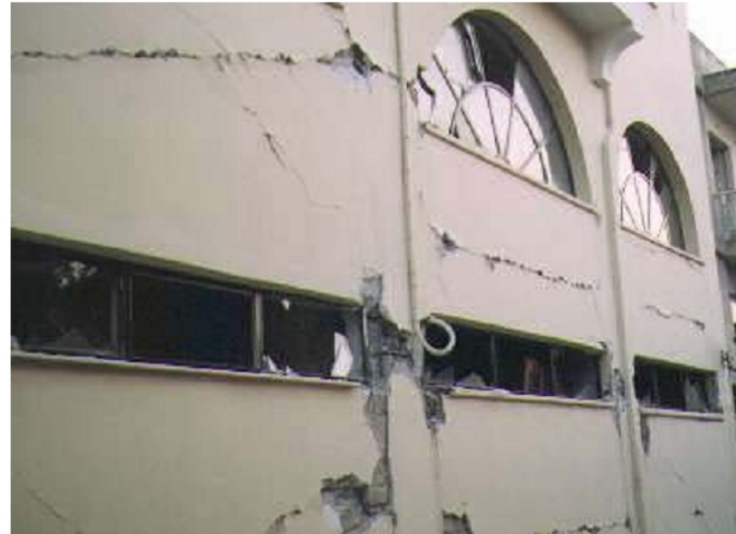
Φωτ. 8 Βλάβες σε «κοντά» υποστύλωματα.
