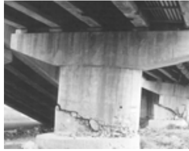
Σχήμα 8.2.: Αστοχία καμπτικού τύπου.
