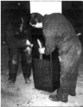
Σχήμα 6.1 Ενίσχυση υποστυλώματος με μανδύα σύνθετων υλικών σε υπόγειο χώρο στάθμευσης αυτοκινήτων, Δουβλίνο, Ιρλανδία.
