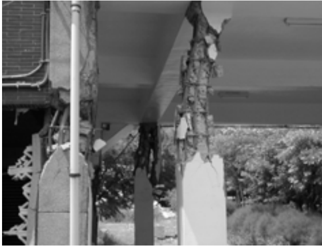
Σχήμα 2.7.: Αστοχία λόγω λειτουργίας κοντού υποστυλώματος και κατασκευής τύπου pilotis.
