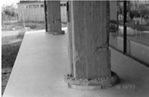
Σχήμα 2.1.: Ρηγμάτωση υποστυλώματος λόγω κάμψης.
