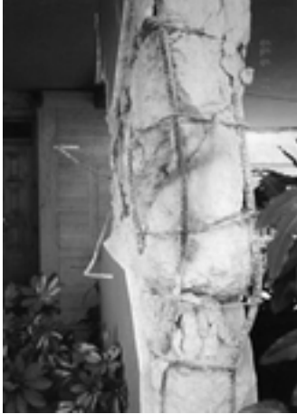
Σχήμα 2.3.: Διακοπή συνέχειας υποστυλώματος λόγω πλήρους αποδιοργάνωσης του σκυροδέματος και βλάβης του διαμήκους και του εγκάρσιου οπλισμού.
