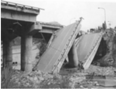
Σχήμα 8.1.: Αστοχία λόγω απώλειας στήριξης.
