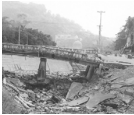
Σχήμα 8.4.: Αστοχία ακρόβαθρου λόγω ρευστοποίησης εδάφους θεμελίωσης.
