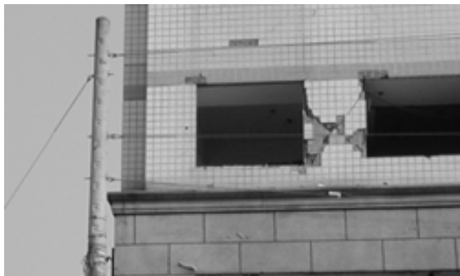
Σχήμα 2.5.: Αστοχία τοιχώματος λόγω διάτμησης.
