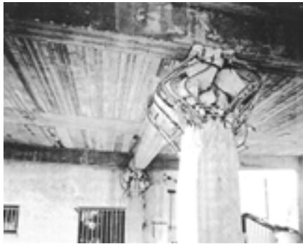
Σχήμα 2.4.: Αστοχία με διακοπή της συνέχειας στοιχείου στην κρίσιμη περιοχή υποστυλώματος και κόμβου.
