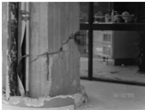
Σχήμα 2.2.: Τοπική αποδιοργάνωση του σκυροδέματος υποστυλώματος.
