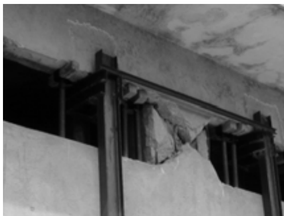
Σχήμα 2.6.: Αστοχία λόγω λειτουργίας κοντού υποστυλώματος.
