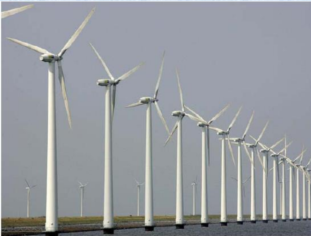
Σχήμα 3.5 Ανεμογεννήτριες με χαλύβδινους σωληνοειδείς πύργους
