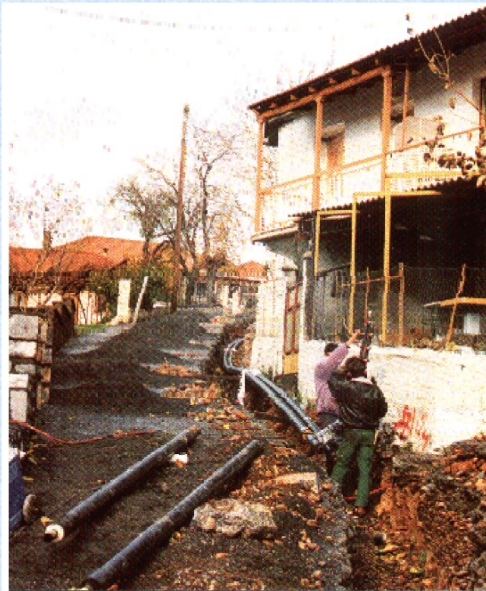
Εγκατάσταση Τηλεθέρμανσης , Νυμφασία
