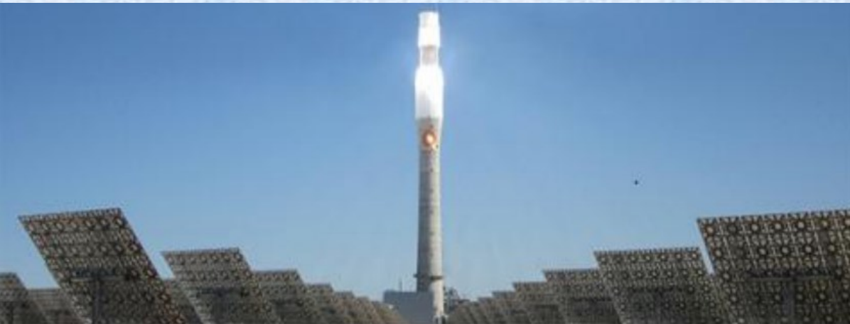
Ηλιακός πύργος Gemasolar, ΗΠΑ
