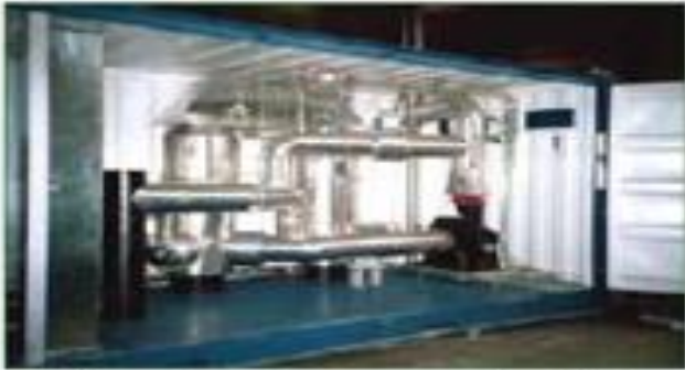
Κινητός καταλυτικός μετακαυστήρας VOC.
