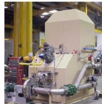
Θερμικός μετακαυστήρας VOC.
